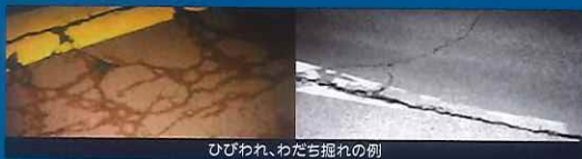
ひびわれ、わだち掘れの例
