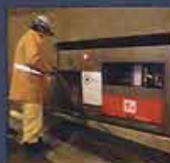
泡消火栓点検
