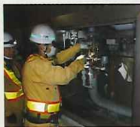
水噴霧装置点検
